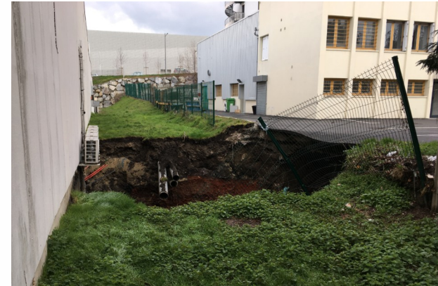
Effondrement localisé à Saint-Etienne
